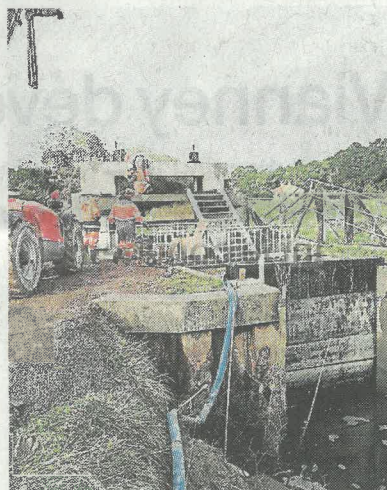
L'écluse du Boursaud, vétuste, subissait de fréquentes pannes.
